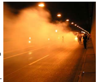
Die riesigen Ventilatoren saugen den Rauch ab
